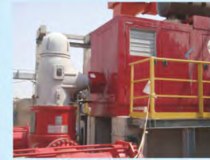
LNG柴油机海水消防泵 CNOOC LNG Station Diesel Engine Fire Pump
