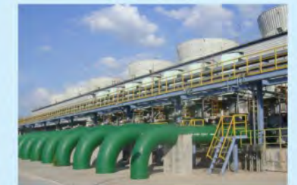
中石化武汉石化80万吨乙烯项目 Sinopec Wuhan petrochemical 800000 tons Ethylene project
