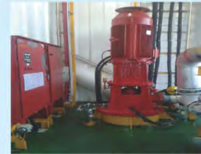
海洋平台(锦州9-3)电动消防泵 CNOOC 9-3 Offshore Platform Electric Fire Pump
