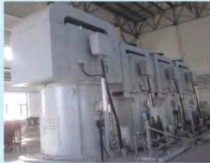
唐山LNG接收站立式长轴海水泵 Tangshan LNG Station Seawater Pump
