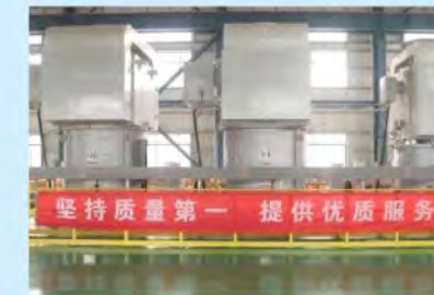
天津LNG海水循环泵 Tianjin LNG sea water circulation pump
